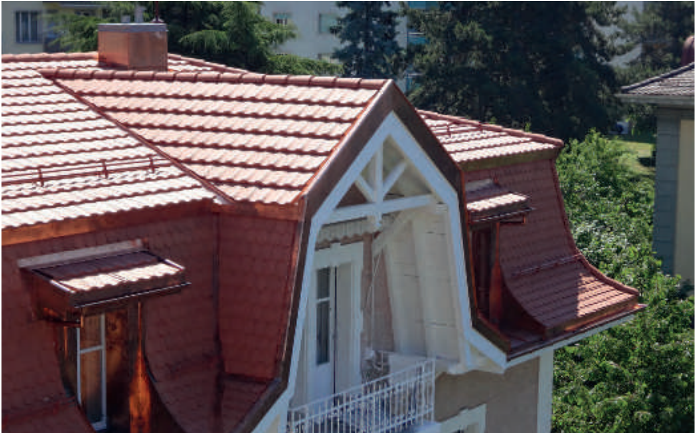
Durch die Sanierung des Daches erstrahlt eines der Gebäude in La Tour-de-Peilz in neuem Glanz.
