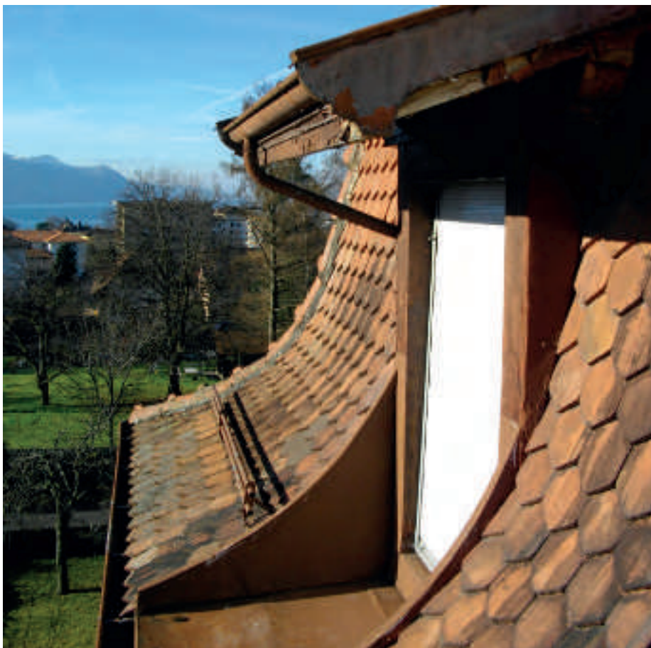
Vor der Sanierung zeigte das Dach erhebliche Altersspuren.
